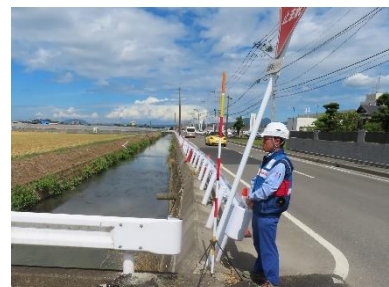
地震で傾いたガードレール
