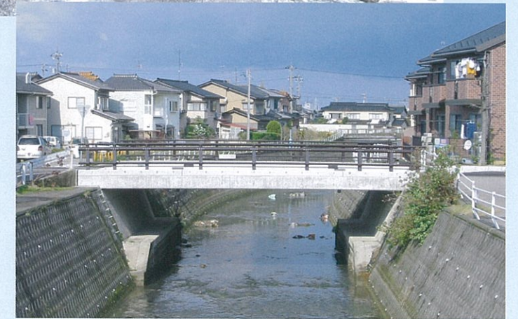
太郎田橋上部工架替工事 橋長13.10m 石川県金沢市(平成16年9月架)
